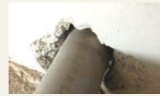
基礎の貫通（鉄筋露出）
