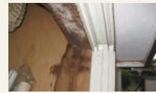
雨漏りによる木部の腐食
