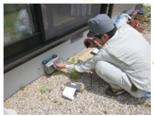
③ 基礎に鉄筋探査機を当て、鉄筋の本数と間隔をチェック
